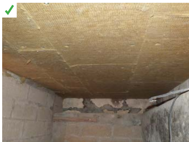
Dans ce petit pavillon de 1925 le plancher bas sur vide sanitaire a pu être isolé en partie dans l'épaisseur à l'aide de panneaux de 12 cm de laine minérale insérés entre les solives. Une seconde couche croisée de 6 cm a été fixée par-dessous. ©AQC
