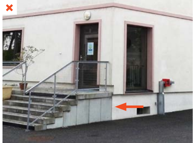
Lors de l'isolation par l'extérieur de cette bâtisse ancienne, le soubassement et les nez de dalles n'ont pas été traités. Il en résulte des ponts thermiques. ©AQC
