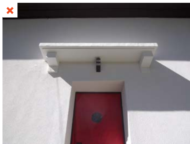
✗ Lors de l'isolation par l'extérieur, l'auvent en béton a été conservé. Un pont thermique a ainsi été créé. ©AQC
