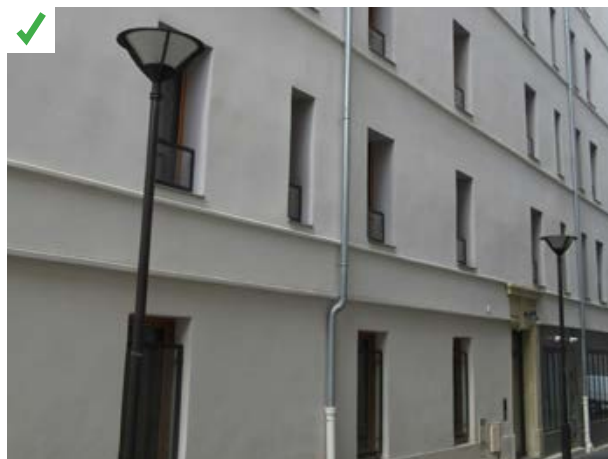
Les interstices entre les pans de bois ont été curetés du plâtre. Un isolant en fibres végétales a été inséré à la place en remplissage et des panneaux d'isolant en fibres végétales haute densité ont été fixés de part et d'autre de l'ossature en pan de bois. ©AQC
