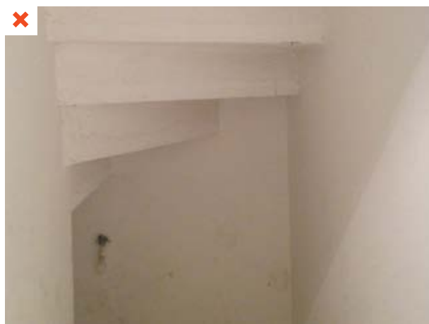
Cages d'escalier non isolées. ©AQC
