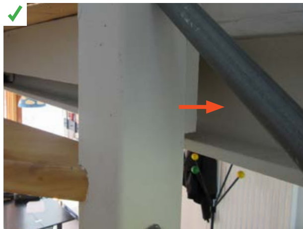
Dans cette rénovation, un plancher léger en bois a été installé entre les poutrelles acier IPN (schéma 2 ci-contre). Des panneaux de chanvre ont été logés dans le bac ainsi créé. Un plancher bois massif recouvre l'ensemble. ©AQC
