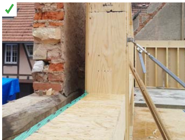
Dans un bâtiment existant très vétuste et afin d'atteindre un niveau de performance élevé, mise en œuvre d'une nouvelle enveloppe ossature bois préfabriquée en atelier à l'intérieur de l'ancienne enveloppe en brique.
