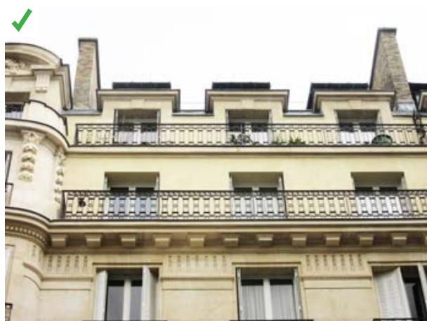
Les deux étages d'attique ont été isolés par l'extérieur avec 8 cm d'un enduit aérogel thermo-isolant appliqué selon la méthode classique. À noter le peu de recul sur le comportement dans le temps de cette solution innovante. ©AQC
