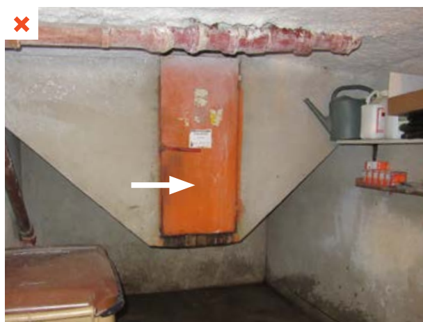
L'ancien système de vide-ordures donnant sur un volume non chauffé a été conservé sans travaux d'isolation ni d'étanchéité à l'air. ©AQC
