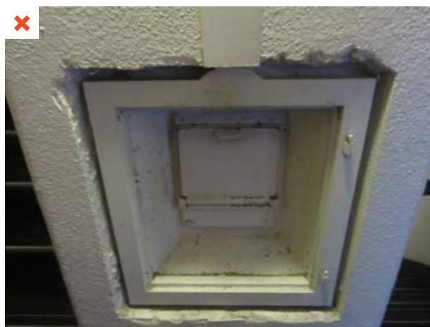
Ancienne trappe de vide-ordures conservée en l'état sans amélioration de l'étanchéité à l'air. ©AQC
