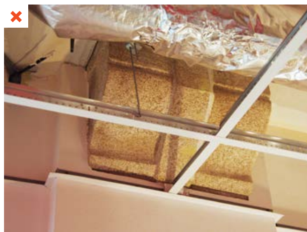
✗ Corbeaux en pierre saillant à l'intérieur non isolés. Leur forme particulière demande un travail de découpe conséquent pour réaliser leur isolation. Ce travail n'a pas été jugé nécessaire car ils ne seront plus visibles après l'installation du faux plafond technique. ©AQC
