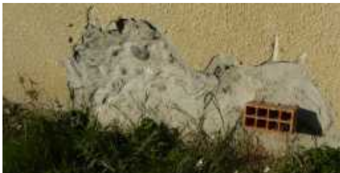
L'entrée du réseau de ventilation, côté est. La brique sera coupée au ras du mur lorsque les enduits seront piqués.
