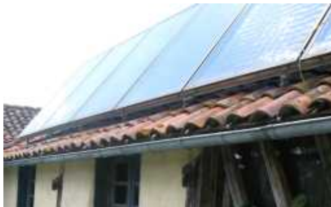
Les 6 panneaux solaires sont posés au sud.
