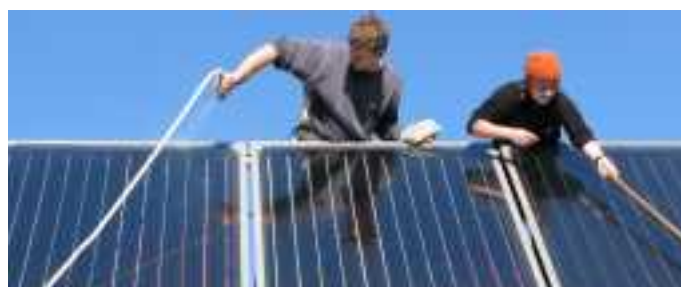
Nettoyage des panneaux solaires.
