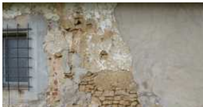
Mur de galets et enduits dégradés par l'humidité.
