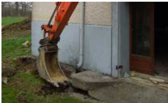
Sous le trottoir en ciment situé en façade sud, le sol est gorgé d'eau, même en plein été.
