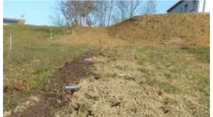
Vue depuis le bas du système avant recouvrement des tuyaux par les tuiles canal : les tuyaux arrivent au-dessus des tranchées remplies de BRF.
