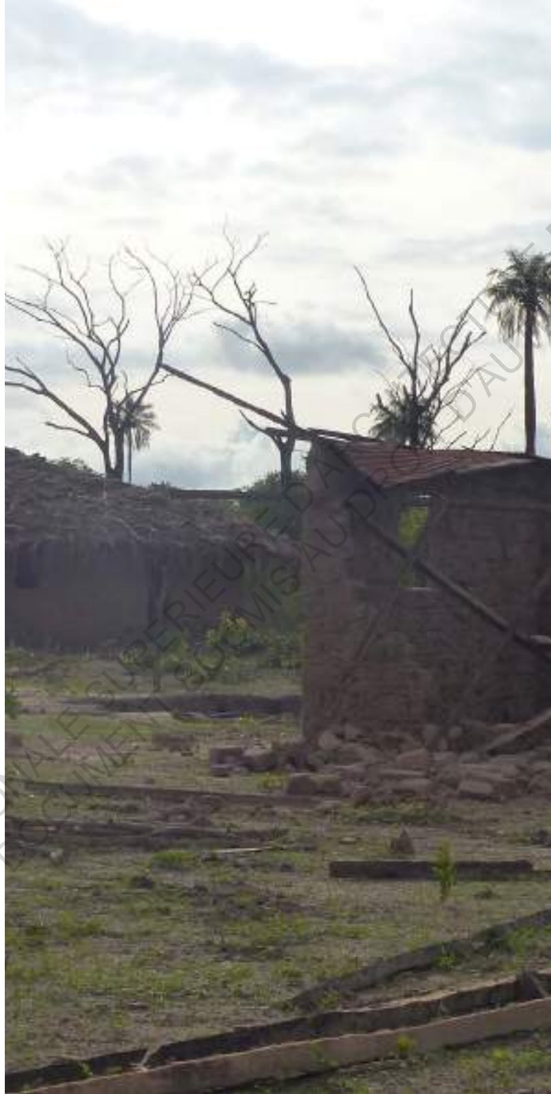
Maison en latérite et couverture de tôle détruite par l'hivernage en Casamance >
